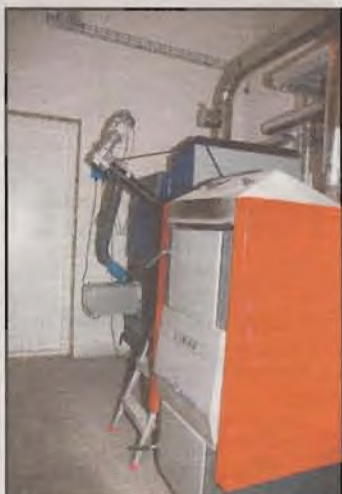
Slik ser varmeanlegget ut som skal forsyne både hus og produksjonsavdelingen med varme. (Foto: Rita Harildstad)
